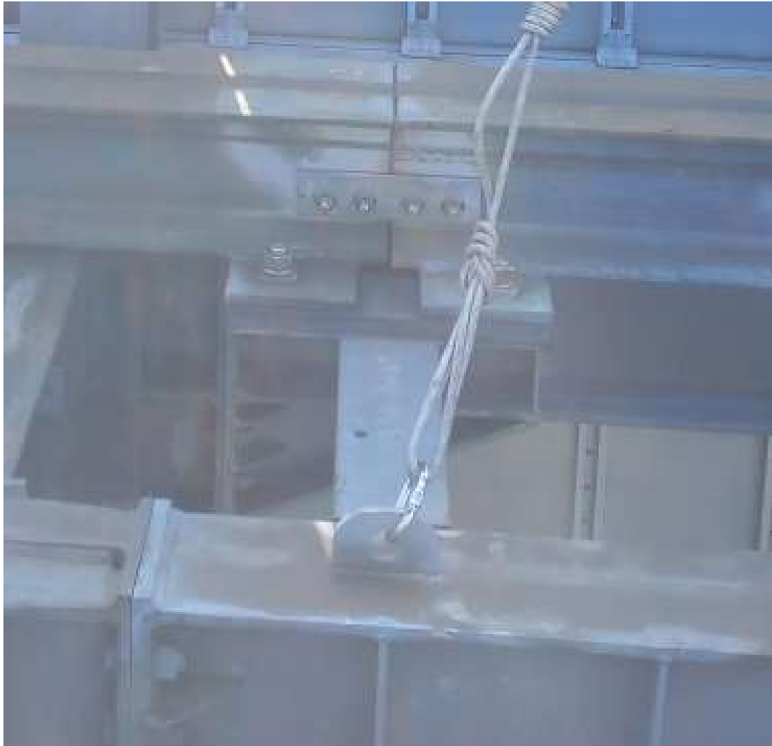
Photo 28. Lubang Pengikat atau Angkur Poin yang Didesain Menyatu Dengan Struktur Baja H. Lifting Point or Anchorage Point Designed Built in to H Beam Structure.
